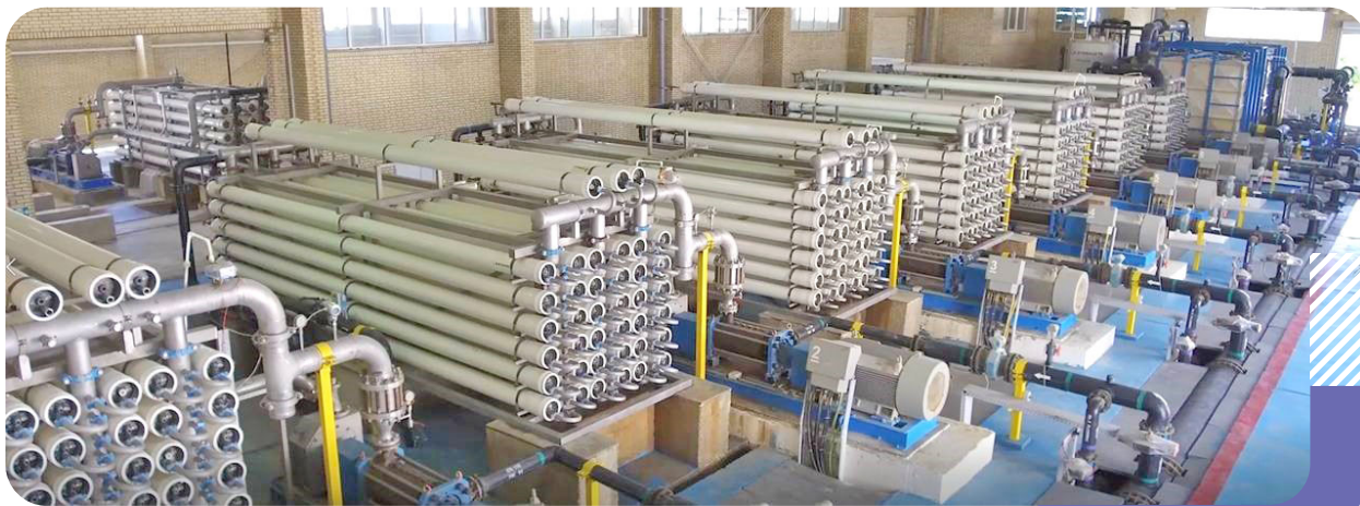
پکیج‌های RO فاز اول تأسیسات آب شیرین کن چابهار-کنارک
